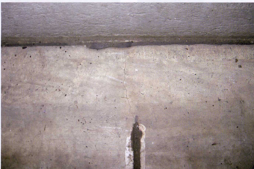
Een goed ontwerp en uitvoering kan noodzakelijk herstel voorkomen. De zaagsnede is onvoldoende ver doorgezet.
