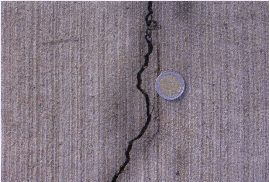
Een doorgaande scheur, ongeacht de breedte, betekent een niet-vloeistofdichte vloer.
